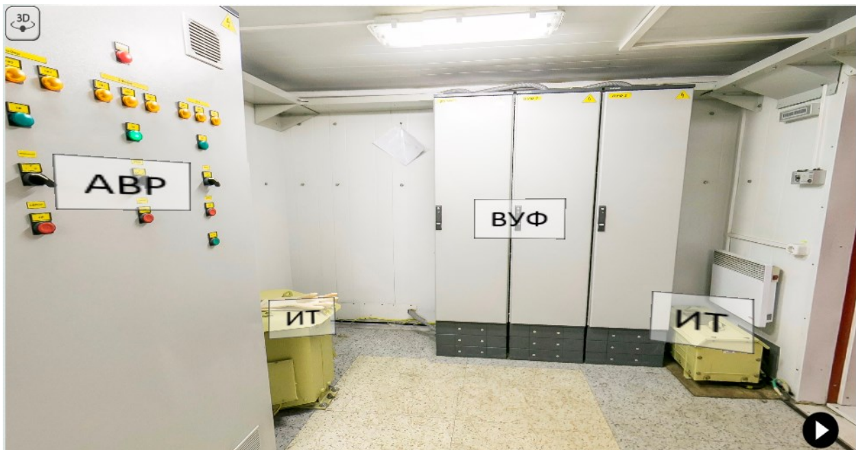
Рисунок 1. Пример 3D-панорамы помещения электропитающей установки МПЦ Ebilock 950
